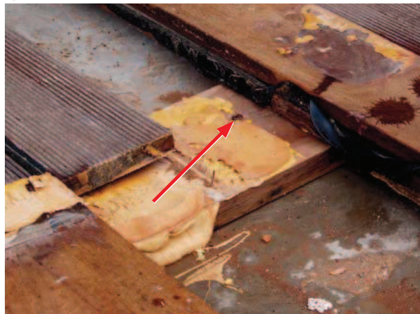
Slika 5: Detalj otkrivene potkonstrukcije terase: pruga vodootporne furnirske ploče s nanosom gumenog ljepljiva uvijena izravno u beton (strelica) i adhezijski lom na drvu obloge (gore desno)
